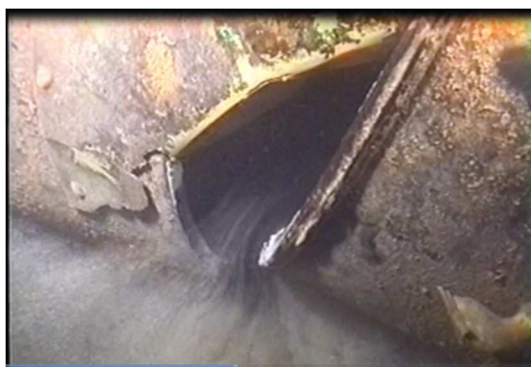
Slika 1 Ena izmed več namernih poškodb natege.
